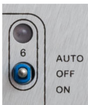
Figure 2-3: Le contacteur de vanne du panneau de contrôle est réglé sur "OFF"
