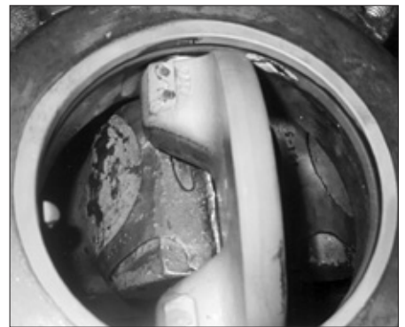
Figura 1 - Válvula fijada correctamente en su lugar.
