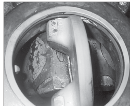
Figura 1 - Válvula fijada correctamente en su lugar.
