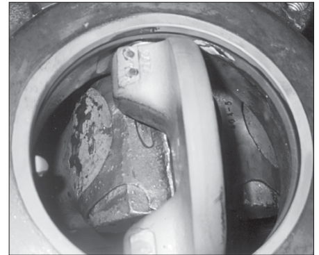
Figura 1 - Válvula fijada correctamente en su lugar.
