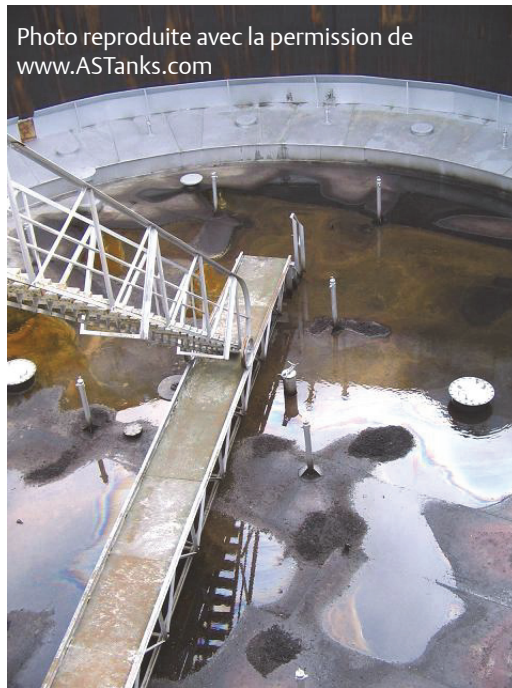
Figure 1-10. Un dysfonctionnement de la vidange de toit est un problème courant.
