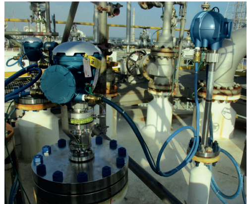
Figure 9.3 : La redondance de bac de stockage est réalisée avec deux jauges de bac ainsi que des couches de communication indépendantes (câblée et sans fil).
