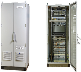
Figure 9.5 : Une armoire du système de téléjaugage.
