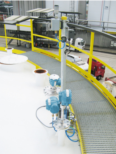
Figure 9.8 : Antenne connectée aux appareils de bac.
