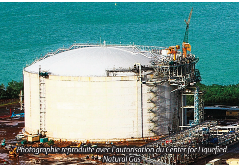
1.4 : Bac cryogénique stockant du GNL à -162 °C.
