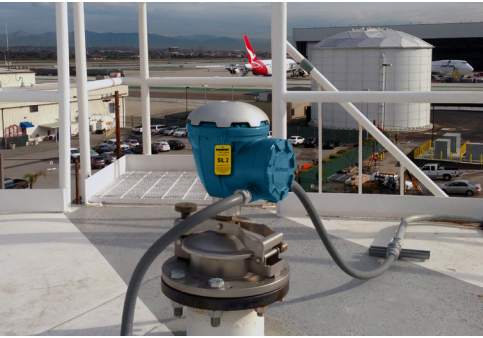
Figure 2.10 : Jauge de niveau radar moderne sur un bac à toit fixe.
