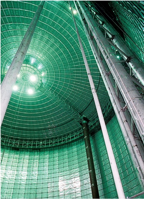
Image 7.4 : Bac de confinement total utilisé pour le stockage de gaz liquéfiés réfrigérés.
