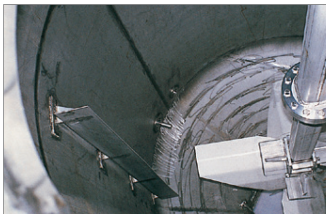
Robinet de prise d'échantillon pour cuve. A l'intérieur de la cuve.
