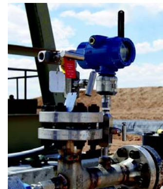
Transmisor inalámbrico de presión 3051S Rosemount instalado.
