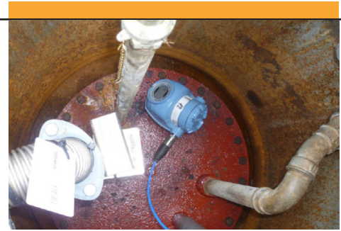
Rosemount 5300 montado en un tanque subterráneo con espacio de aire y posibilidades de conexión limitadas. Las tuberías se extienden dentro del tanque.
