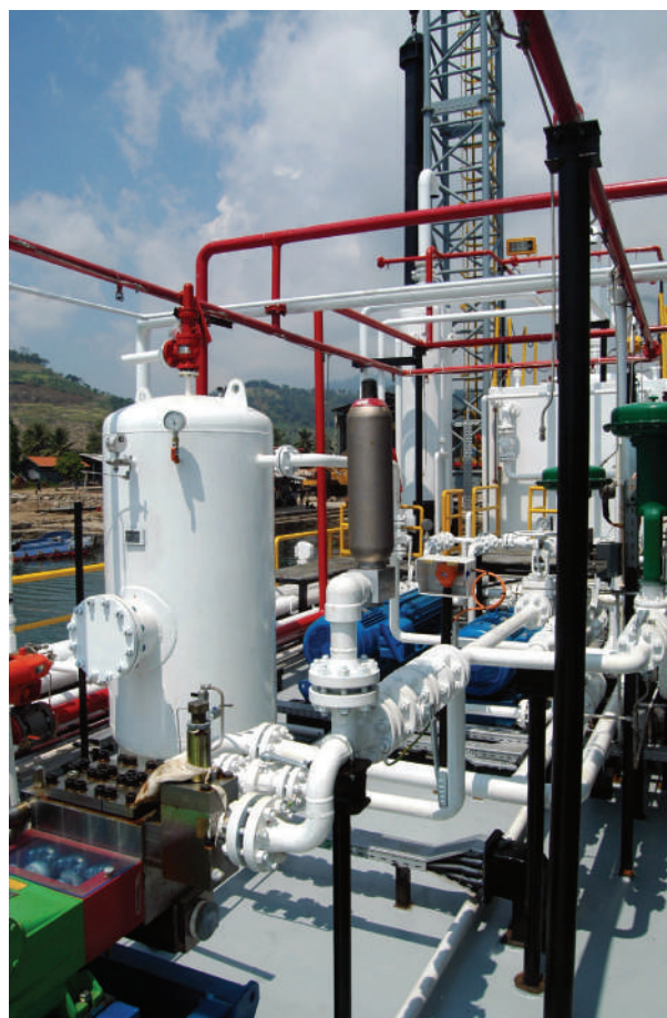
Se muestran válvulas de control Fisher en un entorno en alta mar.
