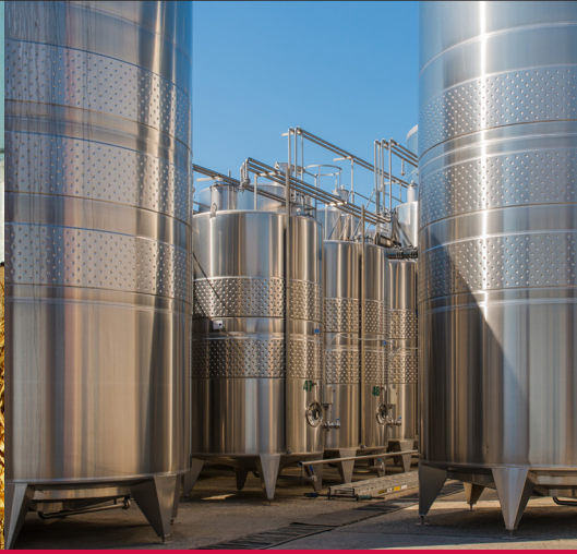
发酵罐与终端设备
