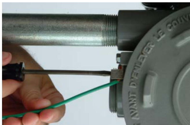
Figure 12 Raccordements à la mise à la terre externe
