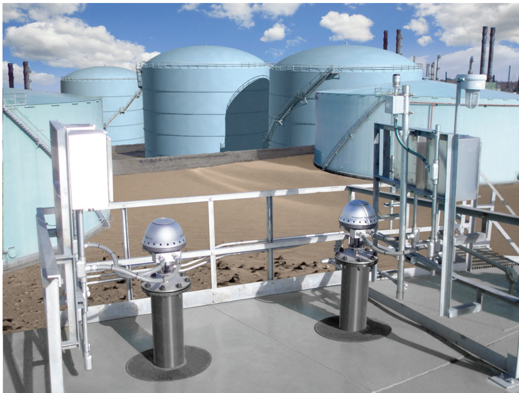
2 ATGs für Füllstandsmessung und Überfüllsicherung. Ein immer häufigeres Bild, wenn alte mechanische Füllstandsschalter durch moderne Lösungen ersetzt werden.
