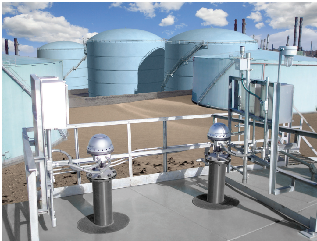
2xATG til niveau- og overfyldningssikring. Et stadigt mere almindeligt syn, når gamle mekaniske niveauelementer udskiftes med moderne løsninger
