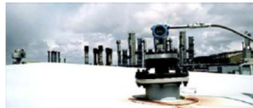
염수처리탱크에 설치된 로즈마운트 3300
