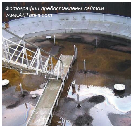
Неправильный дренаж может серьезно помешать работе крыши.
